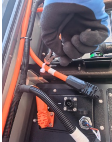
Abbildung 5-1: Verdrahtung der Batteriemodule
