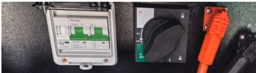
Abbildung 6-2-6: Abschalten der PDU in der Hochvolt-Box
