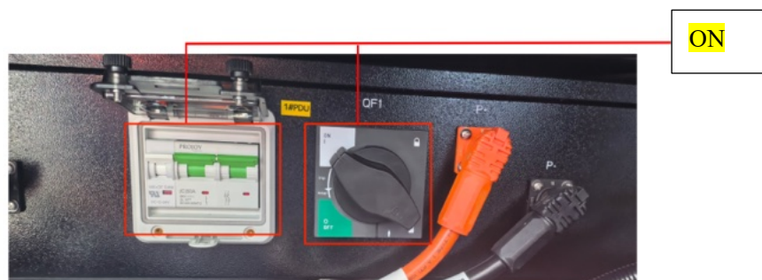
Abbildung 6-1-2: Abgeschlossener Einschaltvorgang an der Hochvolt-Box
